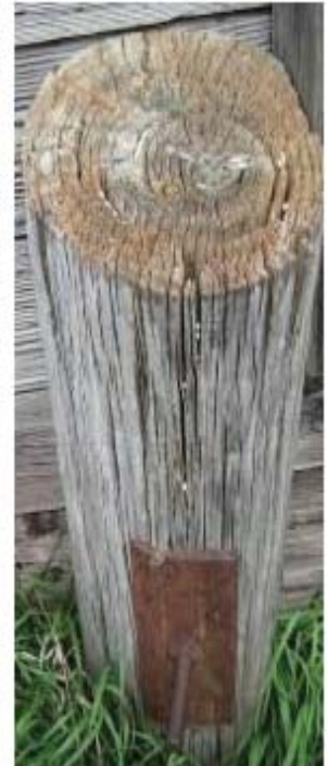
(d) Weathering/UV damage
